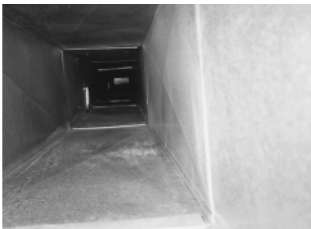
Conduit de distribution (après nettoyage) Source : Environ-air
