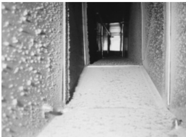
Conduit de distribution (avant nettoyage) Source : Environ-Air
