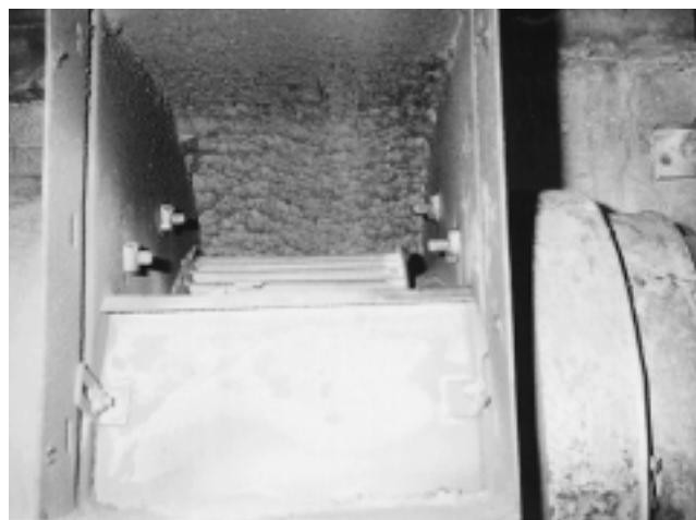
Ventilateur avant nettoyage
